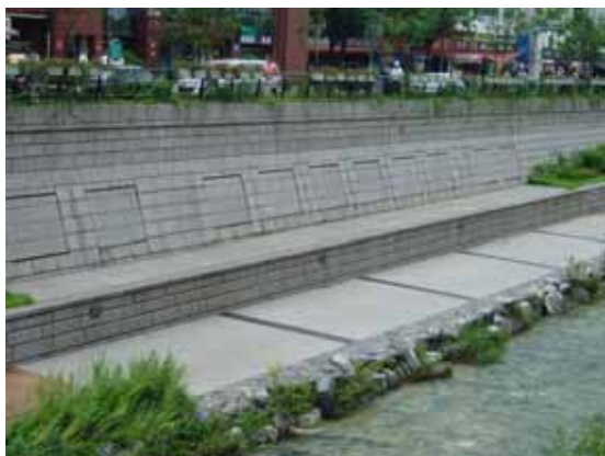
< 開閉式の排水口 > (2006.7.28 撮影)
